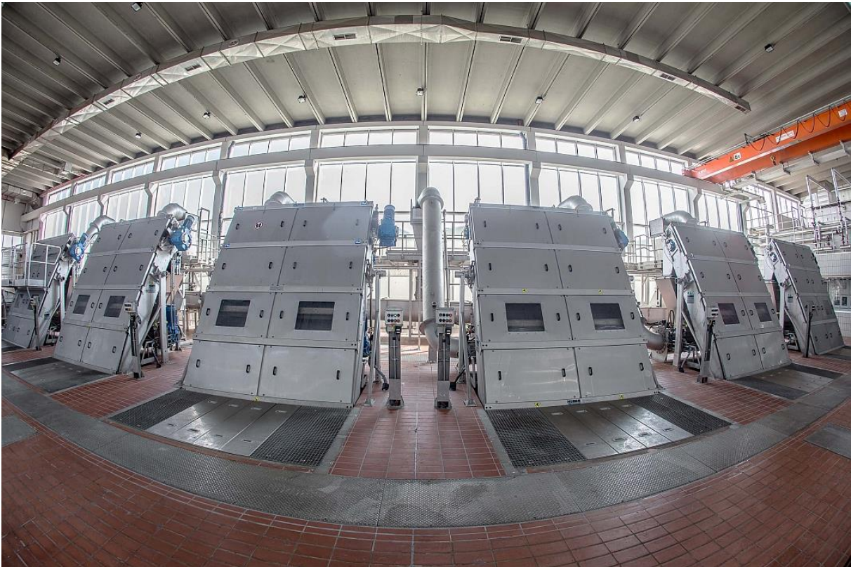
Grobrechenanlage der Wiener Kläranlage
